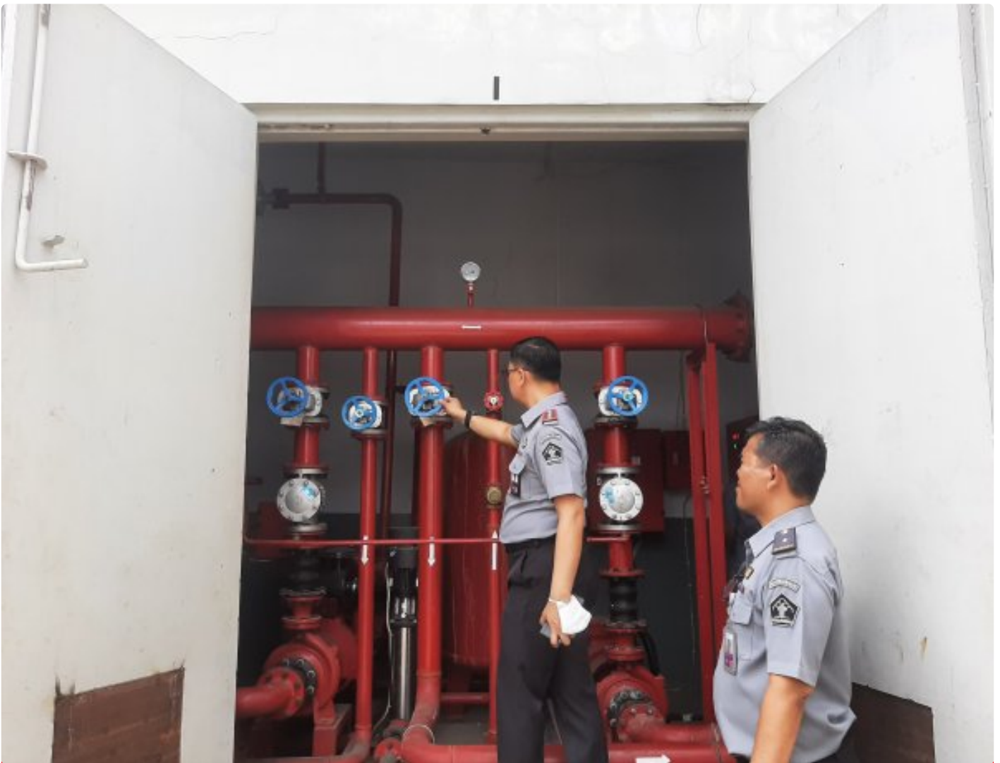
Kalapas Purwokerto, Bayu Irsahara Lakukan Pengecekan Kondisi Hydrant dan Genset
